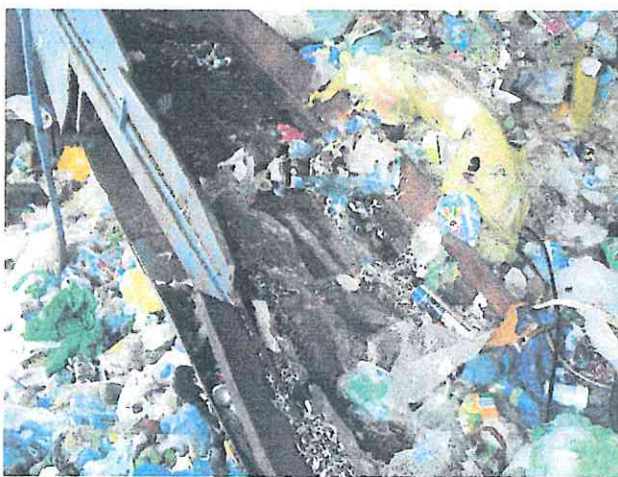
Fot. Nr 4 – uszkodzenia transportera;
