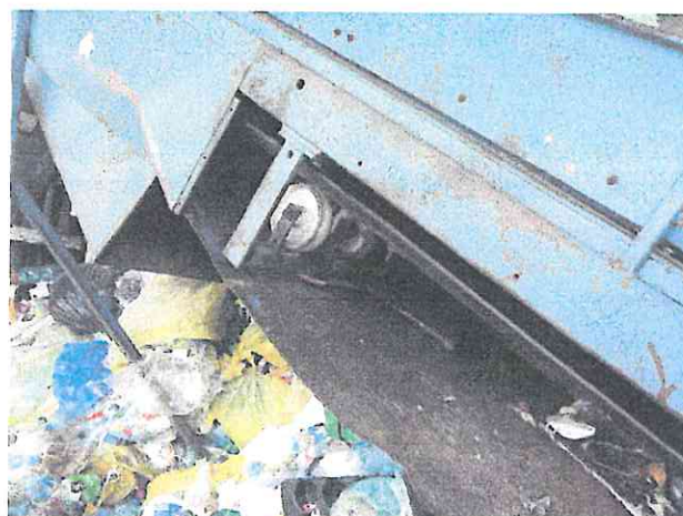
Fot. Nr 6 – uszkodzenia transportera;
