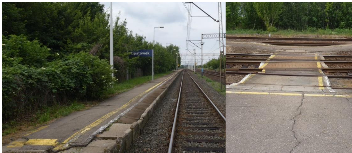
Zdjęcie 22. Zły stan techniczny nawierzchni peronowej na stacji kolejowej w Opatówku.
