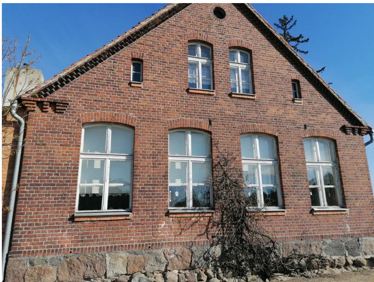
Fot. Nr 2 . Okna wg zapytania strona południowa : z pkt. I.1.
